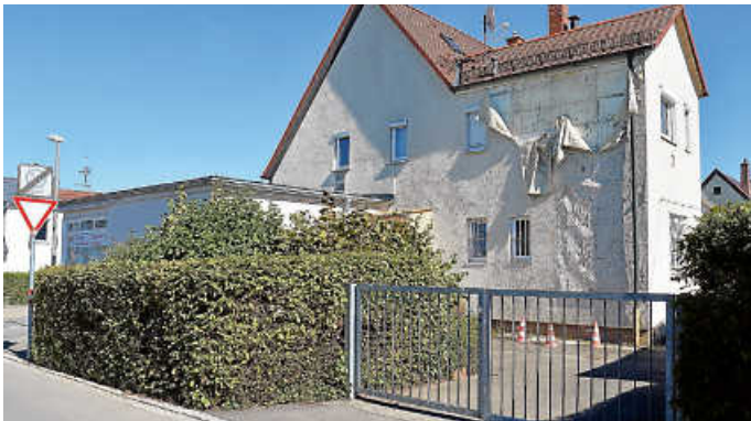
An dem städtischen Haus fällt die Fassade ab.
