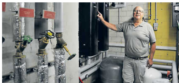
Reinhold Kneißl vom SV Hoffeld zeigt die neue Heizanlage.
