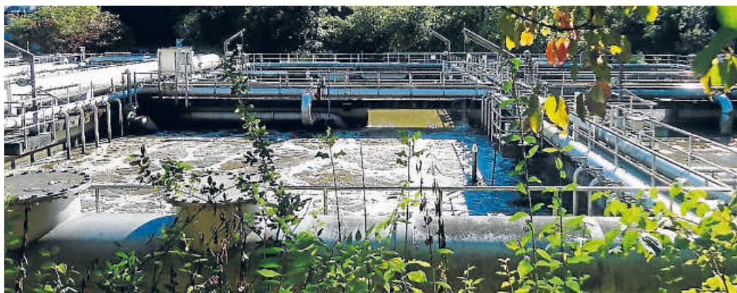
Das Klärwerk reinigt Abwasser aus Möhringen, Vaihingen, Dürtlewang, Rohr und L.-E.
