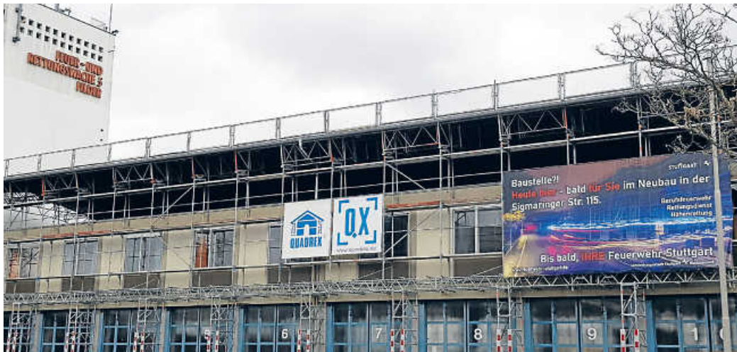
Wegen einem Wasserschadens ist das Gebäude in der Tränke eingerüstet.
