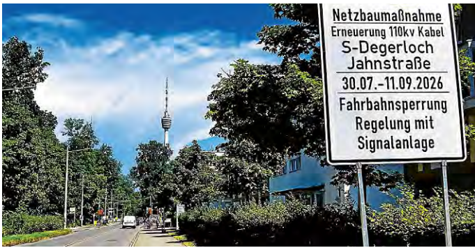
Die Jahnstraße ist derzeit nur einseitig befahrbar.
