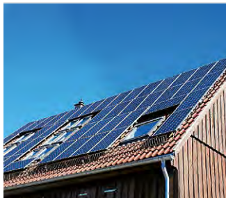
Das Dach liefert Energie. Foto: Stotz
